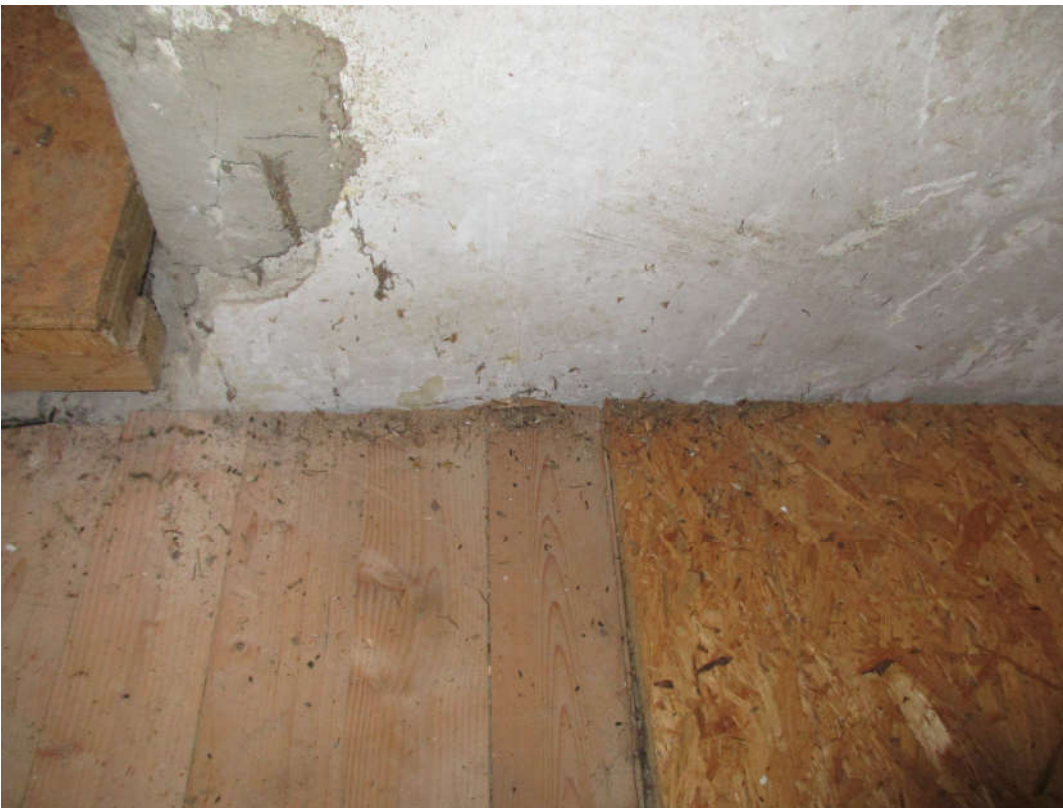
Abbildung 5: Mäusekot im Dachboden
